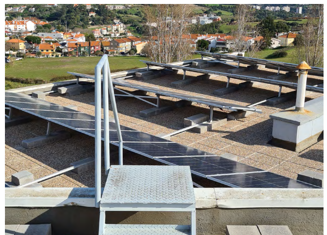
/ Placas fotovoltaicas en el tejado de AstraZenca en Portugal
