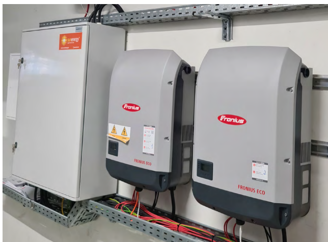
/ 5 inversores Fronius instalados para la conversión de la energía solar en electricidad
